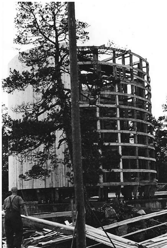
Støpningen av selve vanntårnet ble utført uten avbrytelser, og var ferdig etter 26 timers kontinuerlig arbeid. 60 mann var med på den delen av dugnaden, og arbeidet ble utført på skift à 8 timer. (foto: Knut Thorsteinsen)
